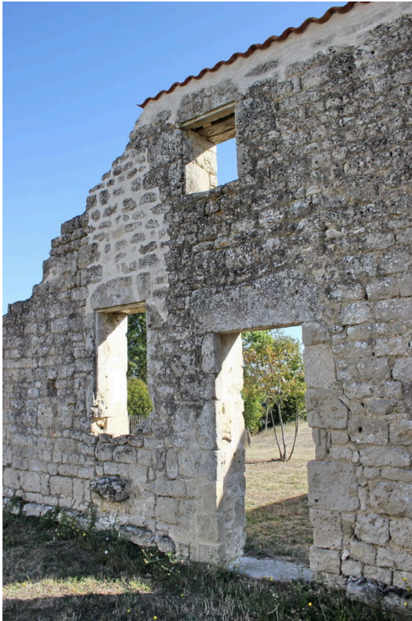
Un détail des vestiges de constructions à proximité de la motte féodale.
