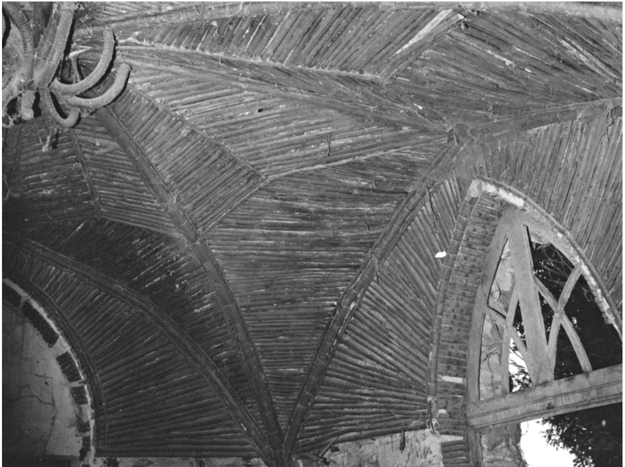
Fabrique de jardin : détail du plafond lambrissé et de sa fenêtre (détruit).
