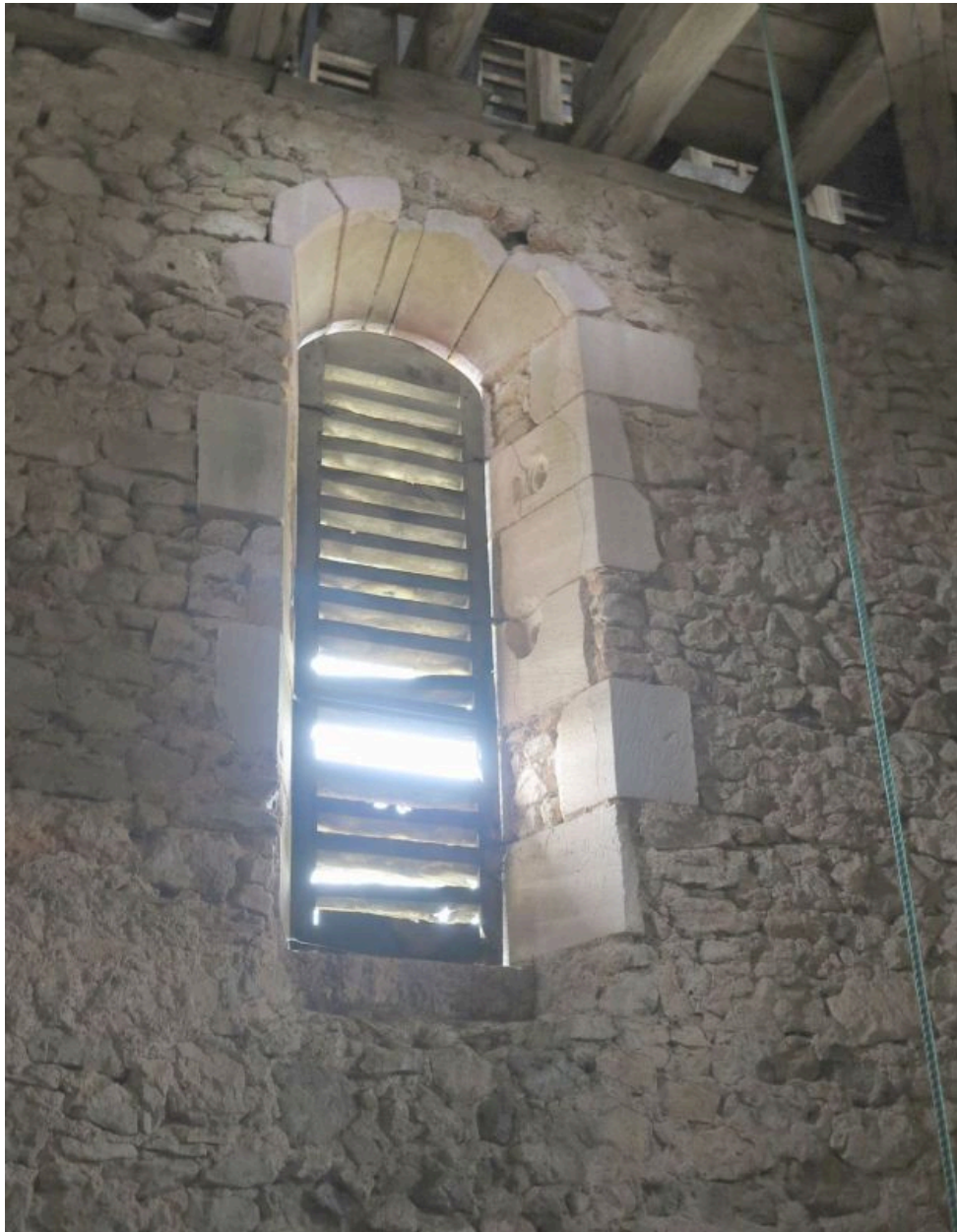
Sud du clocher, baie munie d'abat-son, plusieurs lattes manquent.
