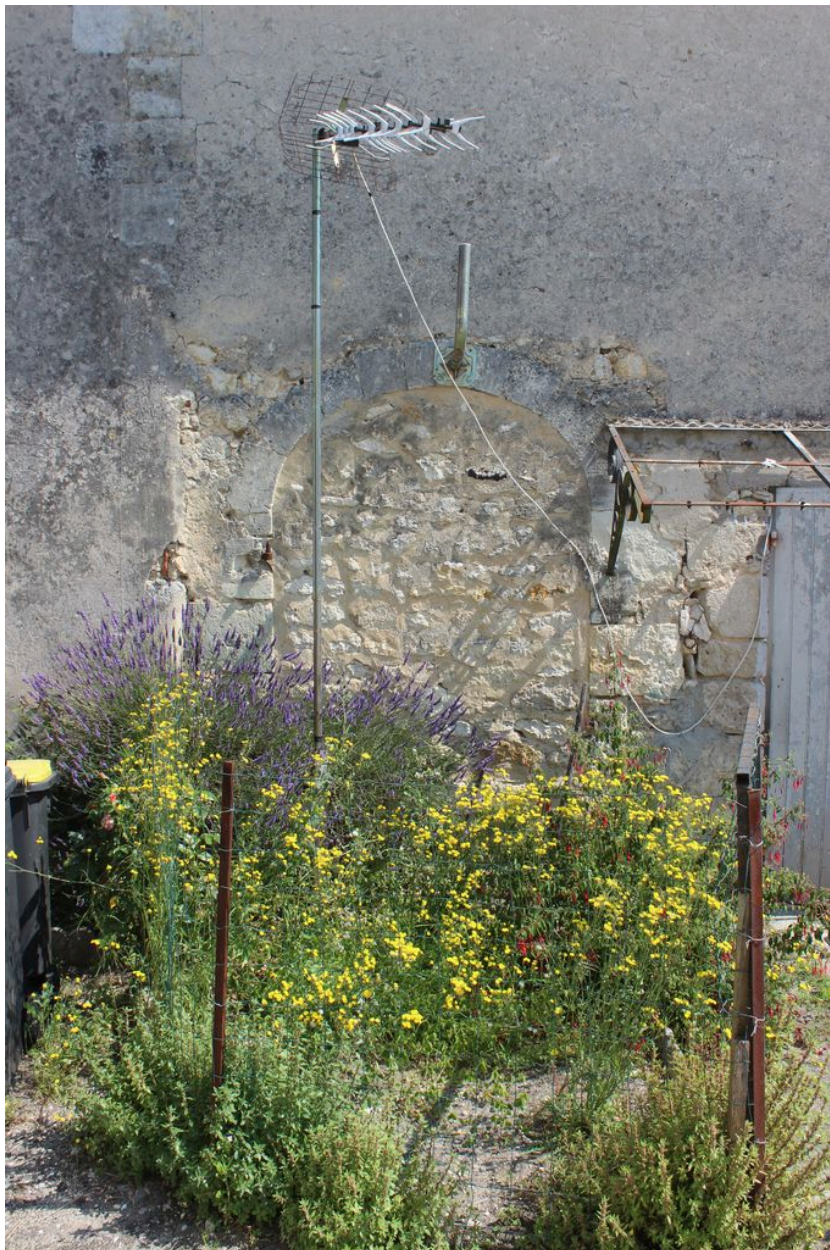
Rue du Médoc, maison (parcelle 2801) : détail de la façade postérieure avec baie de décharge (cuvier).
