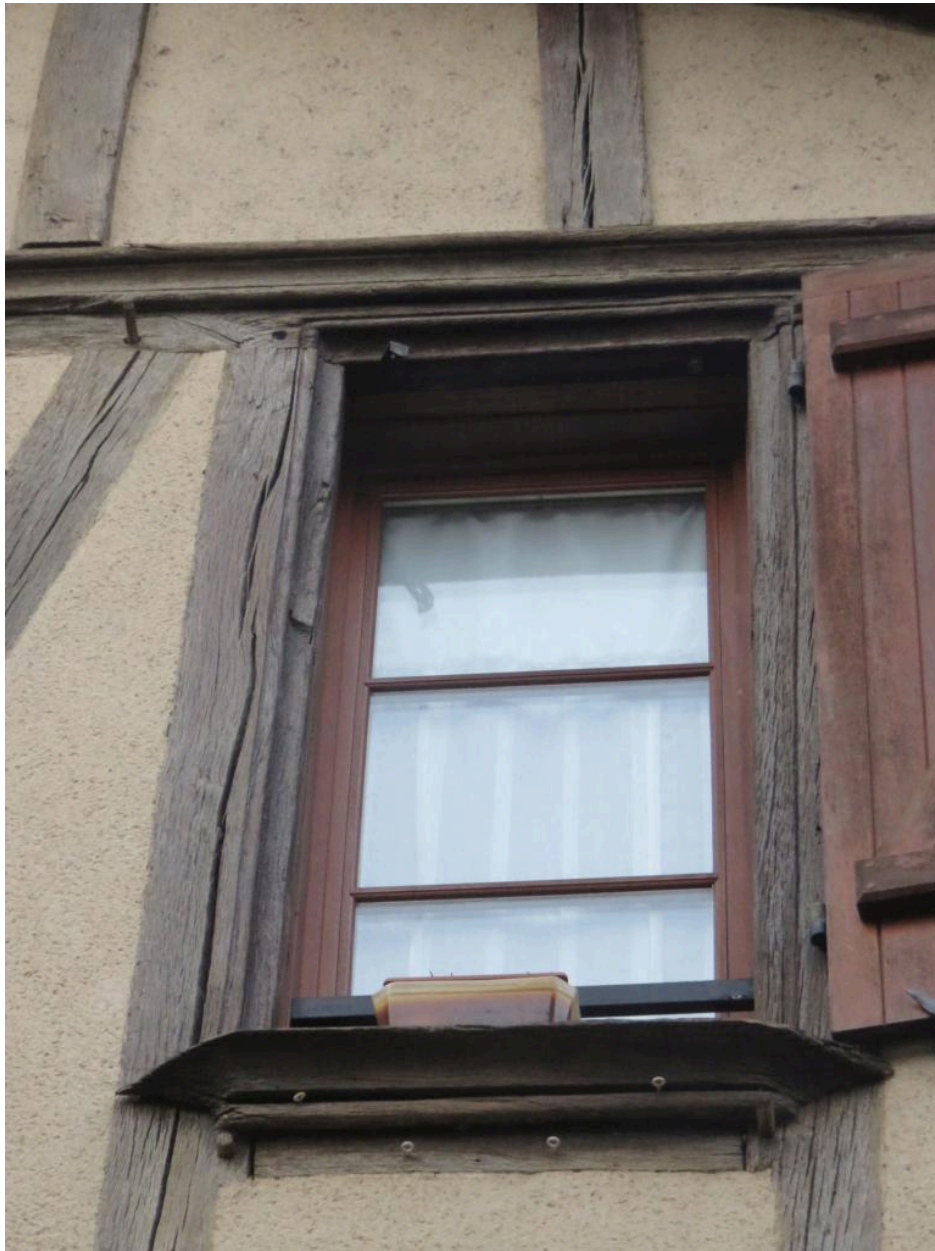
Elévation antérieure, rue des Portes-d'Ansac. Etage, fenêtre droite à appui saillant mouluré ; sablière moulurée, en 2022.
