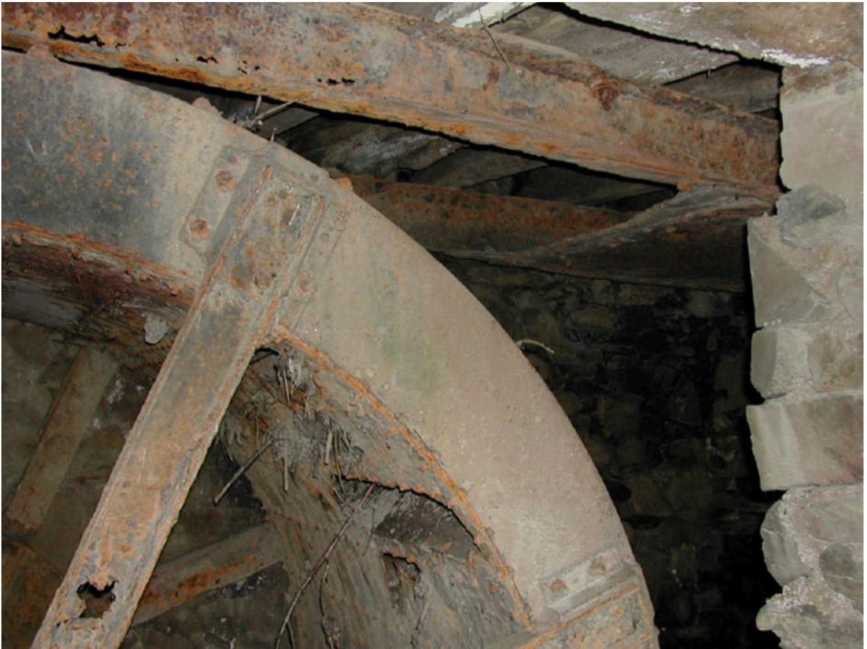
Vue de la roue métallique de dessus : arrivée de l'eau.
