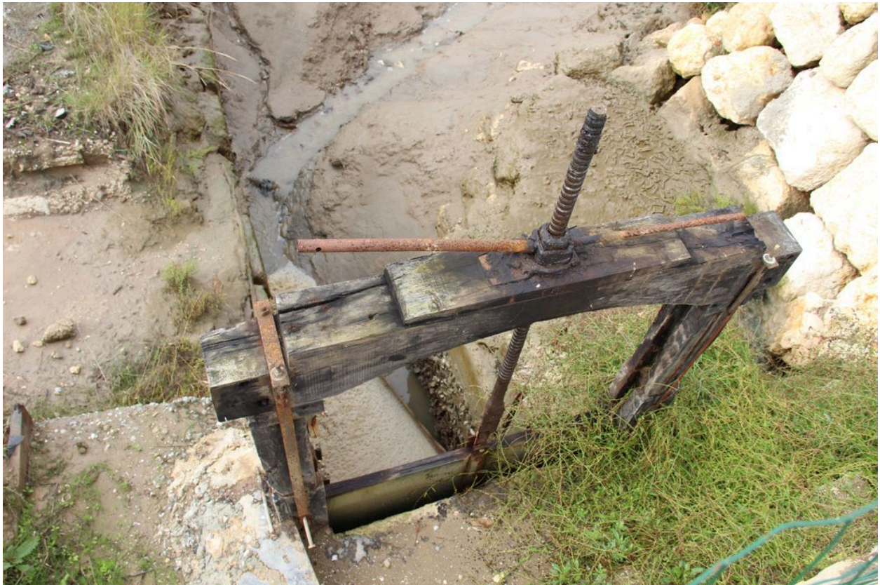
Chenal du Gua ou vieux chenal : vanne aménagée au niveau de la digue latérale au chenal, détail de la pelle.
