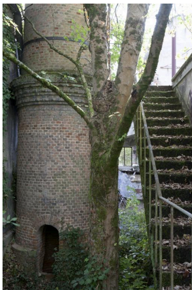
souche de la cheminée de la mégisserie Lagarde. Phot. Philippe Rivière IVR74_20148704019NUCA
