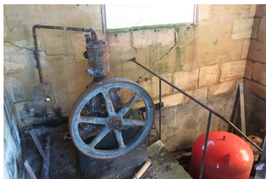
Mécanisme de la pompe. Phot. Claire Steimer IVR72_20163302275NUC2A
