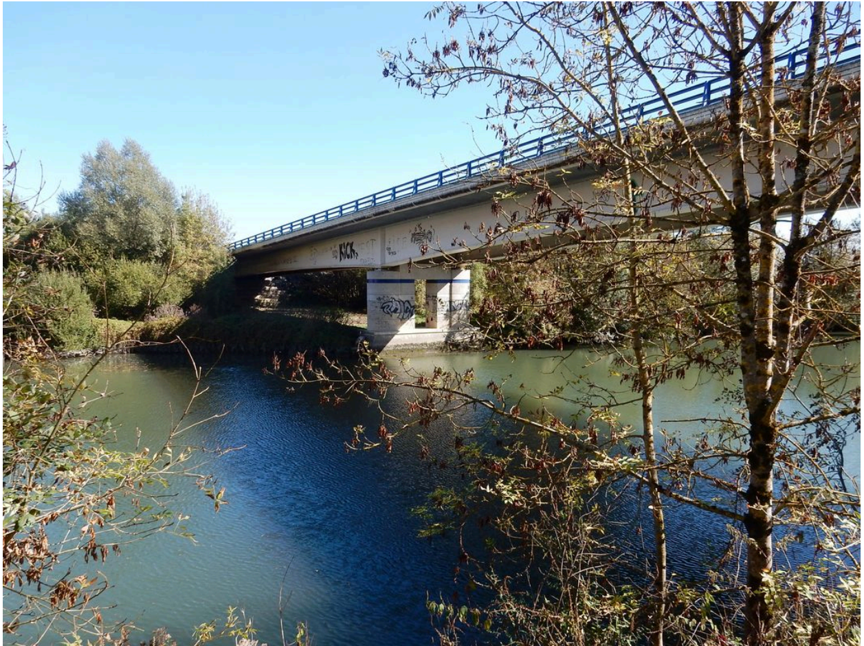
Pile et culée sur la rive droite vues de la rive gauche.
