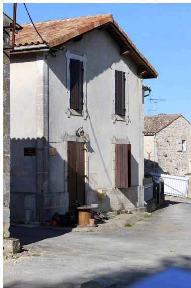
Une vue de la deuxième maison, depuis le sud. Phot. Nathalie Lhuissier IVR54_20171711440NUCA
