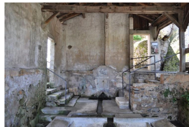
Vue de la fontaine depuis le bassin de lavage. Phot. Maïté Ehlinger IVR72_20186401982NUC2A
