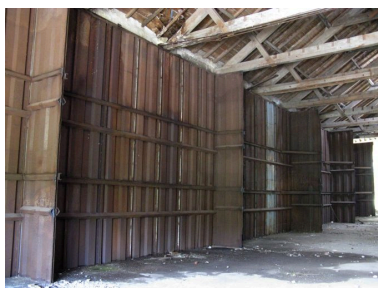
Restes de silos en métal à l'intérieur du bâtiment principal. Phot. Yannis Suire IVR54_20121704980NUCA
