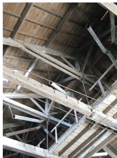
Vis sans fin et tuyaux au faitage du bâtiment principal. Phot. Yannis Suire IVR54_20121704981NUCA
