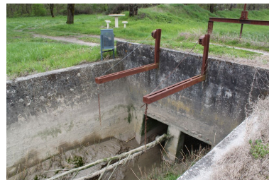
Détail des clapets. Phot. Claire Steimer IVR72_20163301972NUC2A
