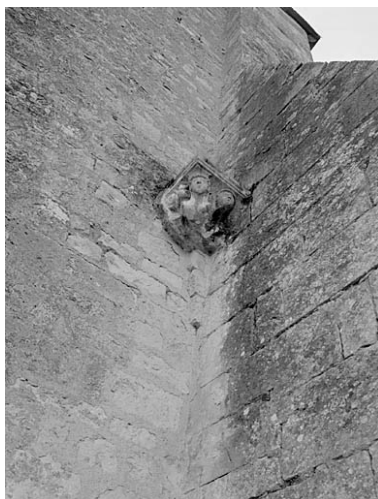
Elévation nord, jonction entre le clocher et le contrefort, chapiteau remployé. Phot. Gilles Beauvarlet IVR54_20031602314V
