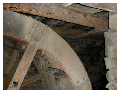
Vue de la roue métallique de dessus : arrivée de l'eau. Phot. Pascale Moisson IVR54_20037900478NUCA
