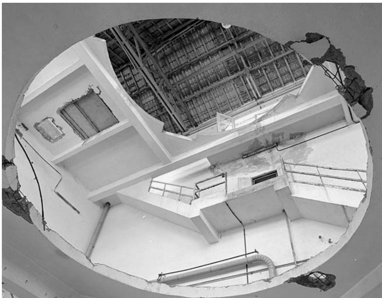
Intérieur de l'atelier de fabrication de la poudre de lait : vue de l'emplacement de la tour Spray.
